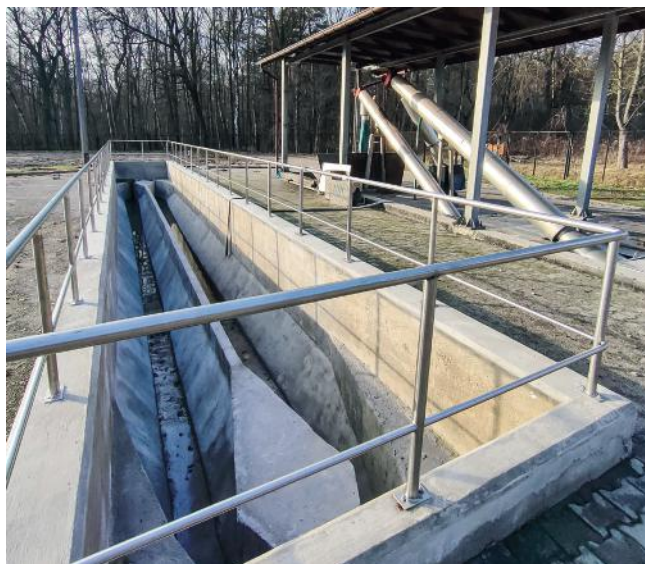
fol. Wodociągi Pawłowice
